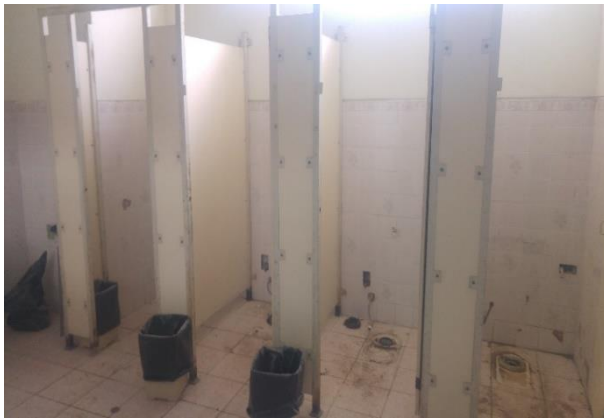
Servicio de gasfitería
